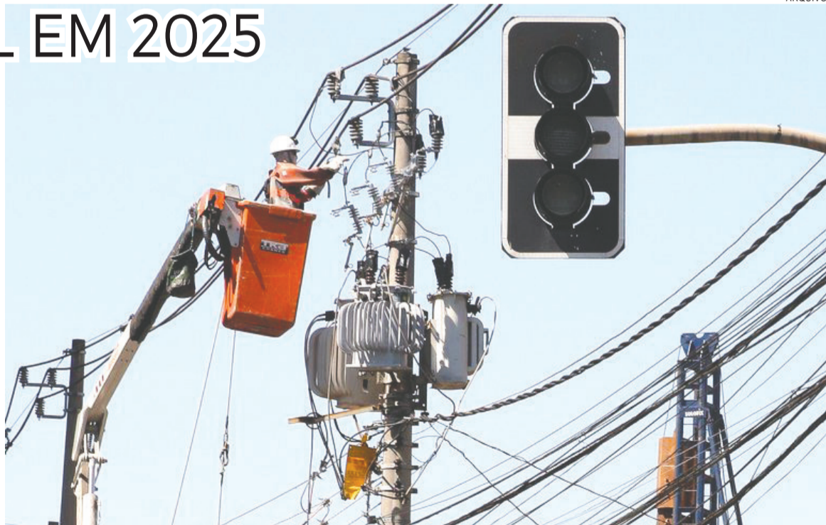
Associação Brasileira de Distribuidores de Energia Elétrica recomenda que somente profissionais devem realizar trabalhos na rede elétrica
